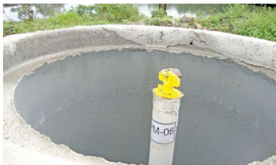
Poço de Monitoramento instalado no Terminal Embraport
